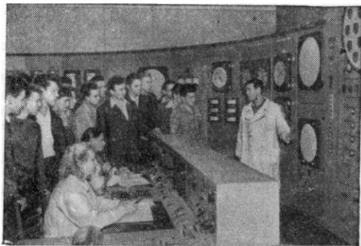
Центральный щит и пульт управления первой атомной электростанции.
